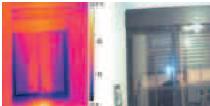
Fotografía 2. Termografía infrarroja de una ventana de aluminio de carpintería de muy mala calidad mostrando una temperatura superficial interior muy baja.
