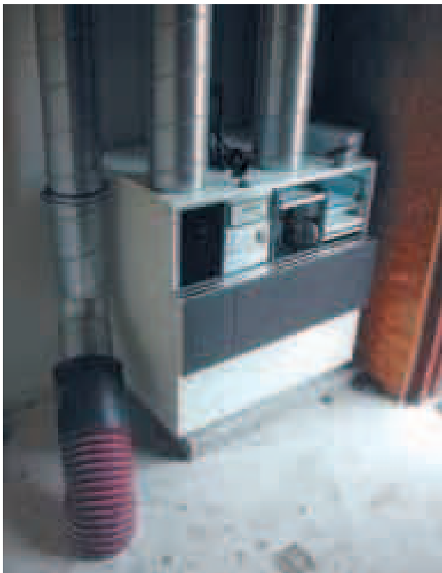
Fotografía 6. Recuperador de calor. Fuente: Wolfgang Berger.
