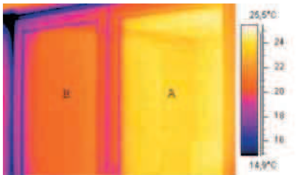
Fotografía 3. Termografía de la superficie de dos láminas de ventana: la lámina (B) muestra menos temperatura, por tanto presenta menos pérdidas de calor que la (A) debido probablemente a: problemas en el recubrimiento de baja emisividad, rotura de una de las dos láminas dobles, fuga del gas argón de relleno.
