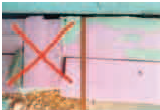
Fotografía 1. Ejemplo de aislamiento MAL ejecutado y de comprobaciones en obra del aislante térmico de perímetro de fachada.
