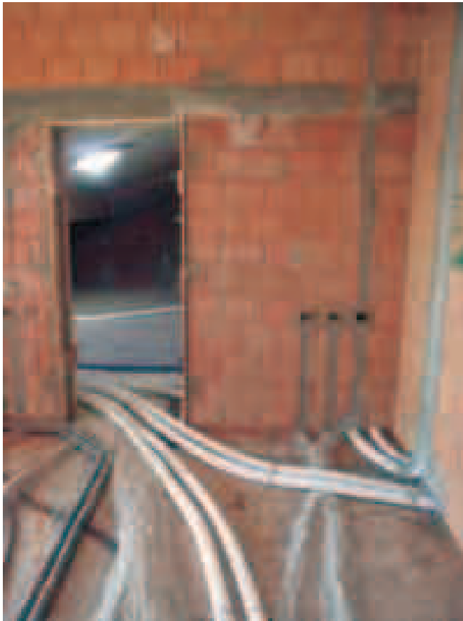
Fotografía 10. Multiresidencial «Sant Anna»: Distribución de los conductos de la ventilación en el suelo. Fuente: TBZ.
